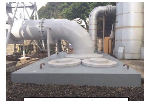
東京電力：神津島発電所
