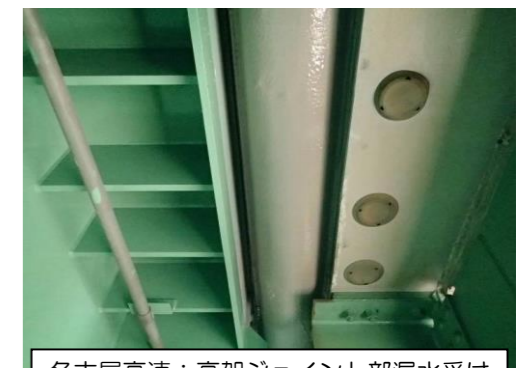
名古屋高速：高架ジョイント部漏水受け
