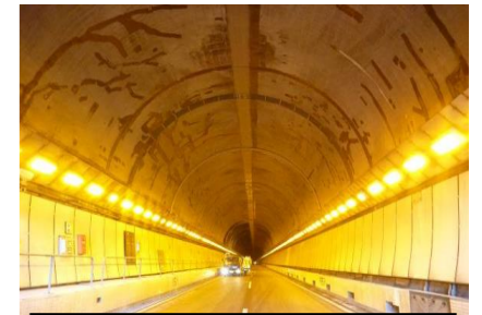
NEXCO中日本：笹子トンネル
